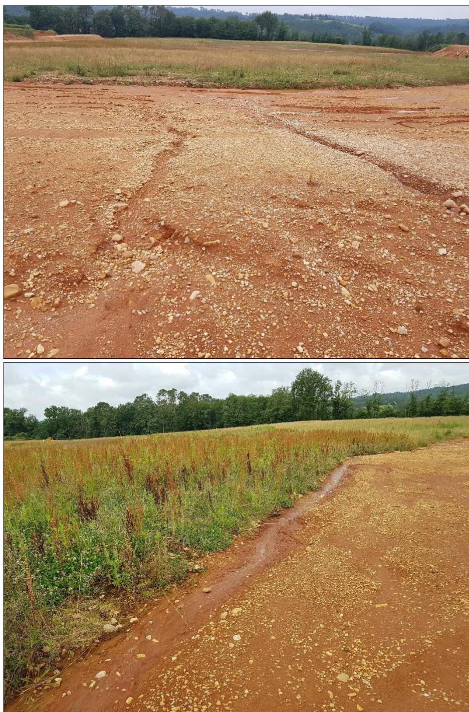
Figure 6 : Illustrations photographiques de traces de ruissellements observées sur site, le 24/06/2021
